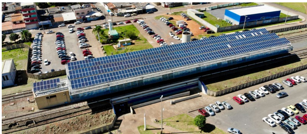
Figura 14. Planta solar na estação de Metrô de Samambaia Sul
