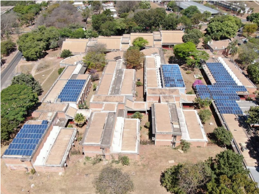
Figura 8. Distribuição dos módulos fotovoltaicos
