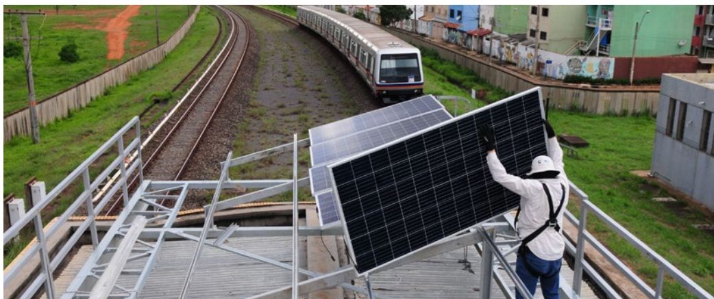
Figura 15. Planta solar na estação de Metrô de Guariroba
